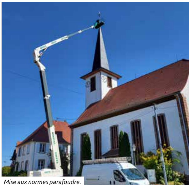
Mise aux normes parafoudre.
